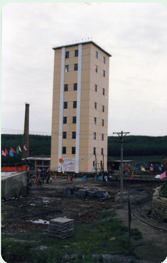
鸡西矿务局小恒山东风井实现整体负重平移（摄于1990年6月3日）
