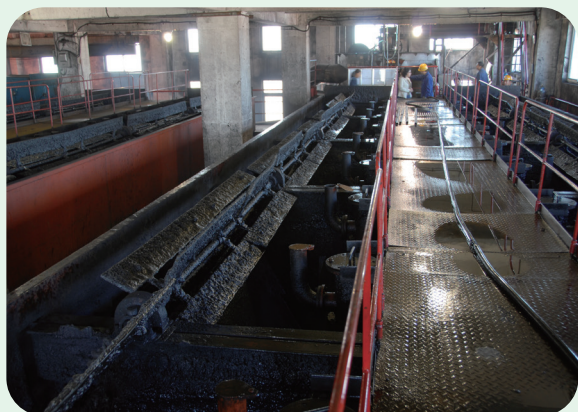
鹤岗矿业集团公司选煤总厂浮选车间
