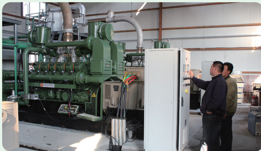
鹤岗矿业集团公司峻德煤矿瓦斯发电站
