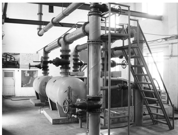
鹤矿集团南山煤矿地面瓦斯抽放泵
