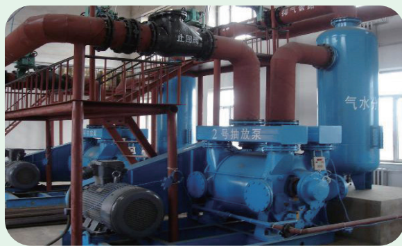
鹤岗矿业集团公司峻德煤矿瓦斯抽放站
