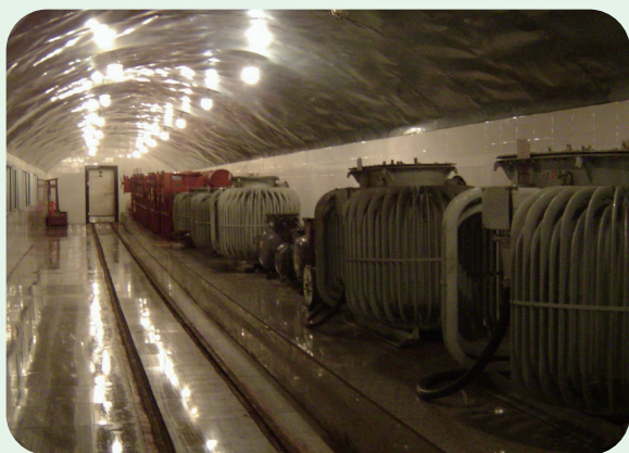
鹤岗矿业集团公司富力煤矿井下-310中央变电所
