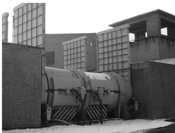
鹤矿集团兴安煤矿压入式 BDK 节能型对旋轴流主扇
